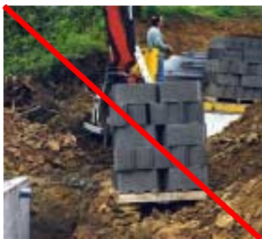
Calage de fortune, effondrement Absence d'aire de stockage
