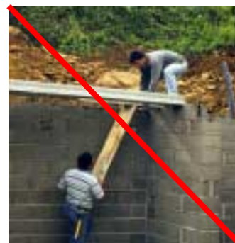
Appuis insuffisants Présence sous les charges
