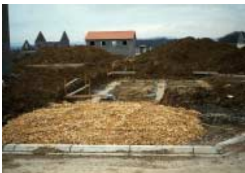
Encrassage de l'accès chantier et de la zone de stockage
